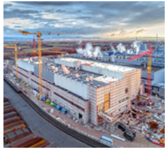
Die Produktionslinie 8 am Standort Kehl wurde 2019 in Betrieb genommen.
